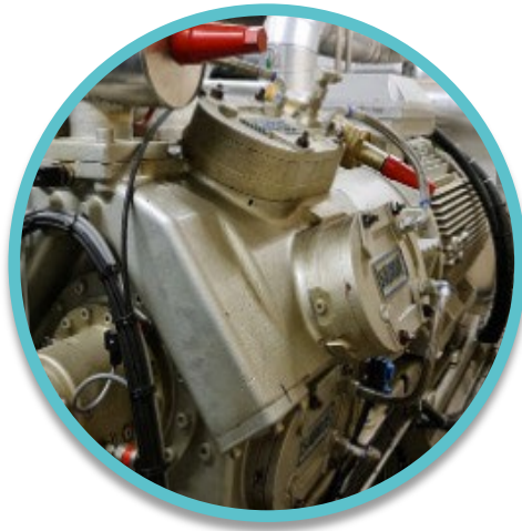
Varmepumpe som primær varmekilde
